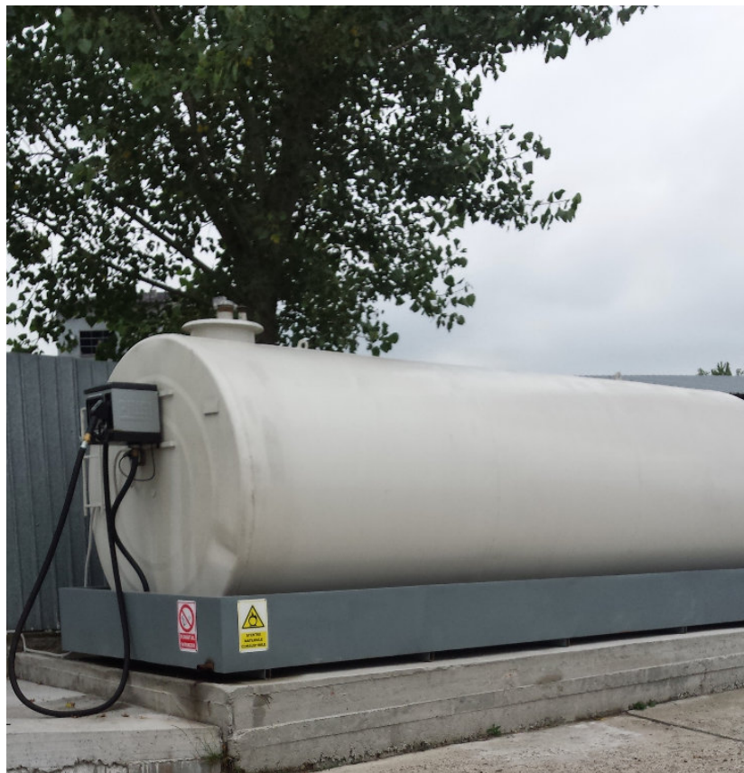
Figura nr. 3. Rezervorul de motorină
