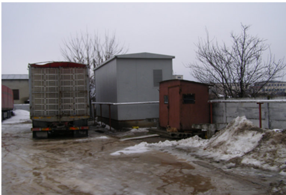
Figura nr. 11. Punct de trecere și măsură de tensiune medie
