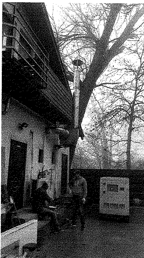
Figura nr. 5. Coșul de evacuare a mirosurilor și aburului din bucătărie
