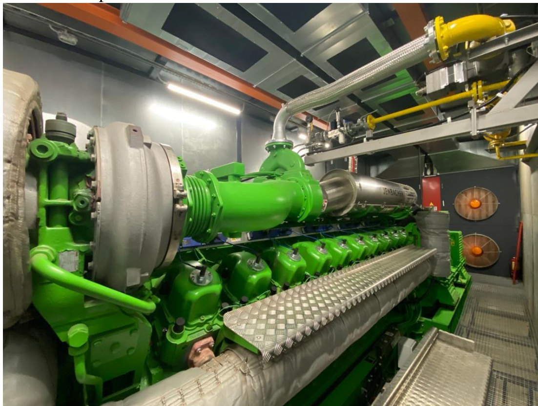
Fig. nr. 4: Imagine din camera motoarelor, detaliu motor JENBACHER
